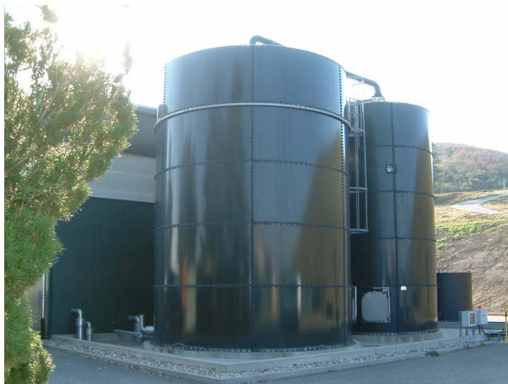
Bild 2: Außenansicht der Anlage mit Speichertanks
