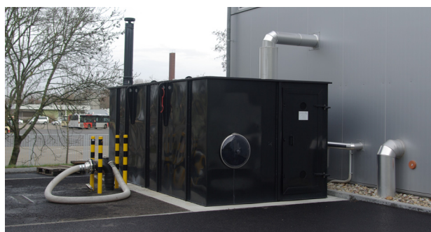
Bild 4: Biofilter zur Abluftreinigung
