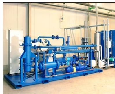
Bild 4: ORC-Anlage Deponie Sinsheim
