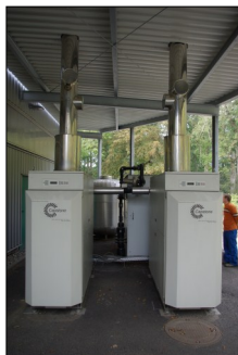
Bild 3: Mikrogasturbinen Deponie Freiburg
